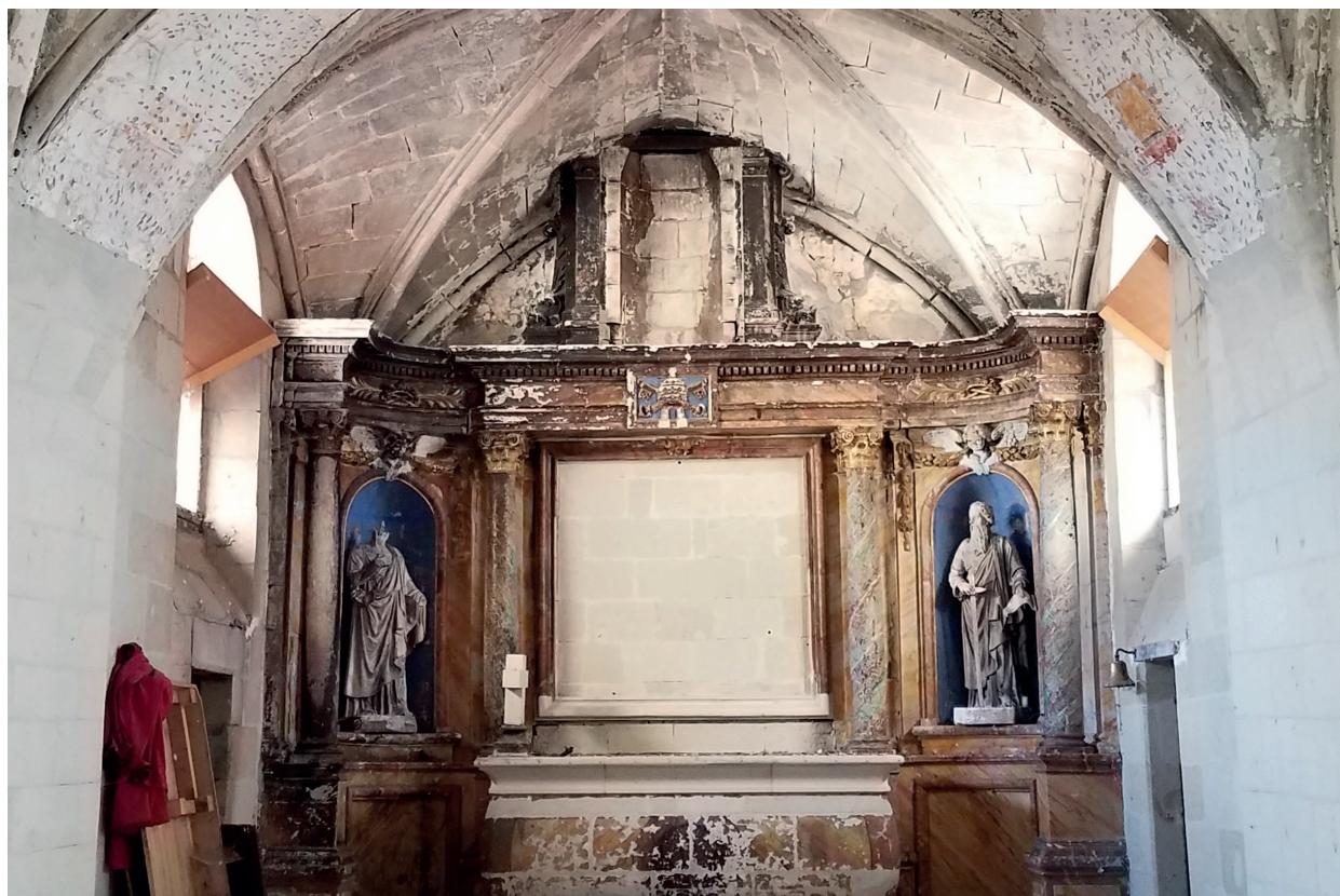
Église Saint-Pierre - Saint-Paul de Bouillé-Loretz, Loretz-d'Argenton, avant sa restauration suite à un incendie
